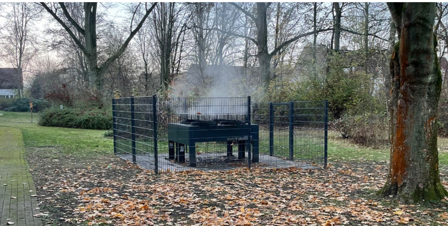
Außeneinheit der Wärmepumpe im Garten der Spittastraße 14-24.
