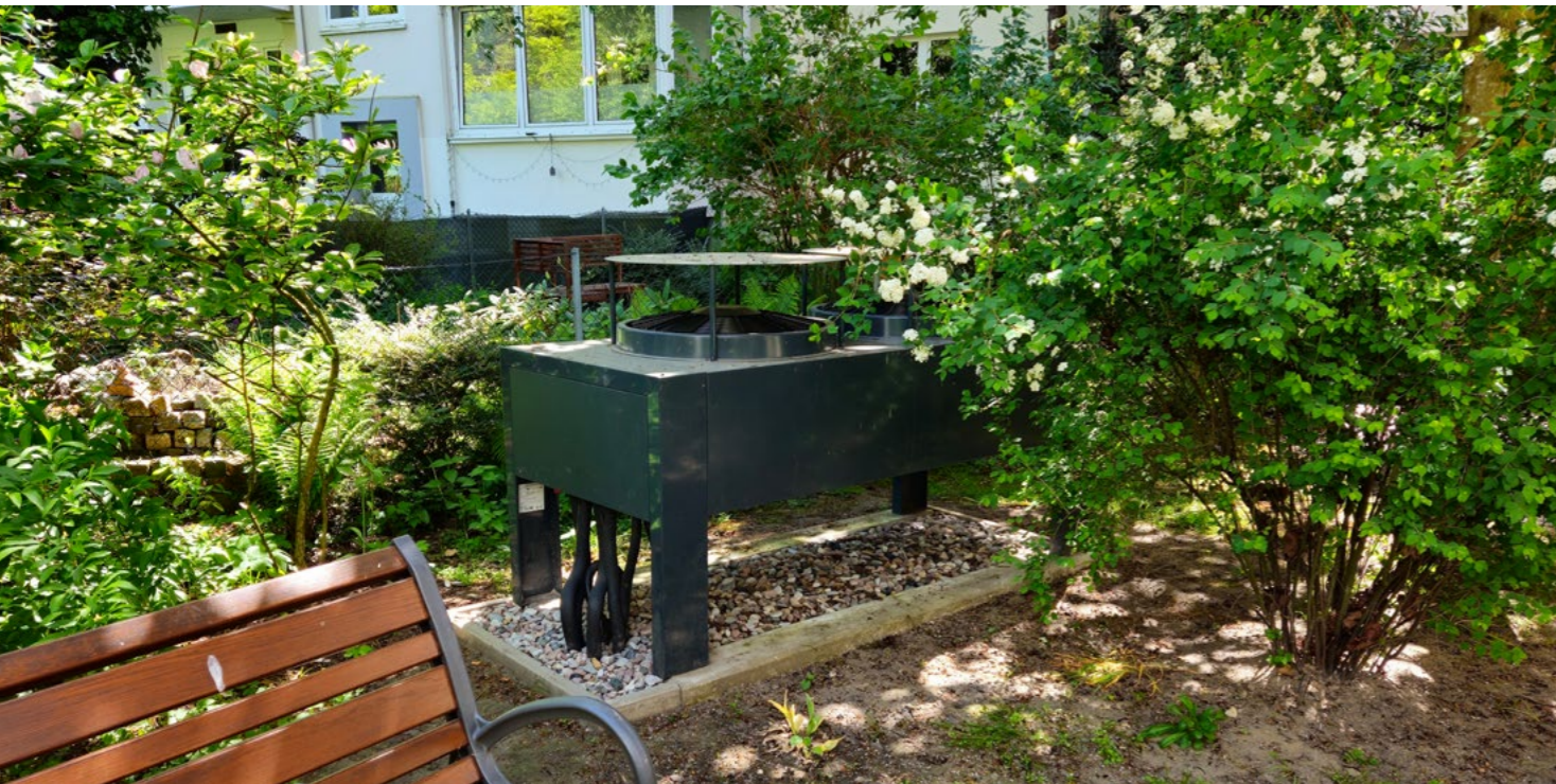
Außeneinheit der Wärmepumpe im Garten der Mendelssohnstraße 9 in der Südstadt.
